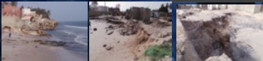
Conséquences de ce phénomène: Destruction de maisons, de littoral et de Pirogues entre Petit Millier et Bellique au sud de Dakar.
