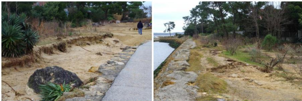
Figure 67 - Dégradation de l'ouvrage sous l'effet des vagues, franchissement par paquets de mer et érosion au sommet et en arrière de l'ouvrage (Lège-Cap-Ferret, 09/01/2014, BRGM).
